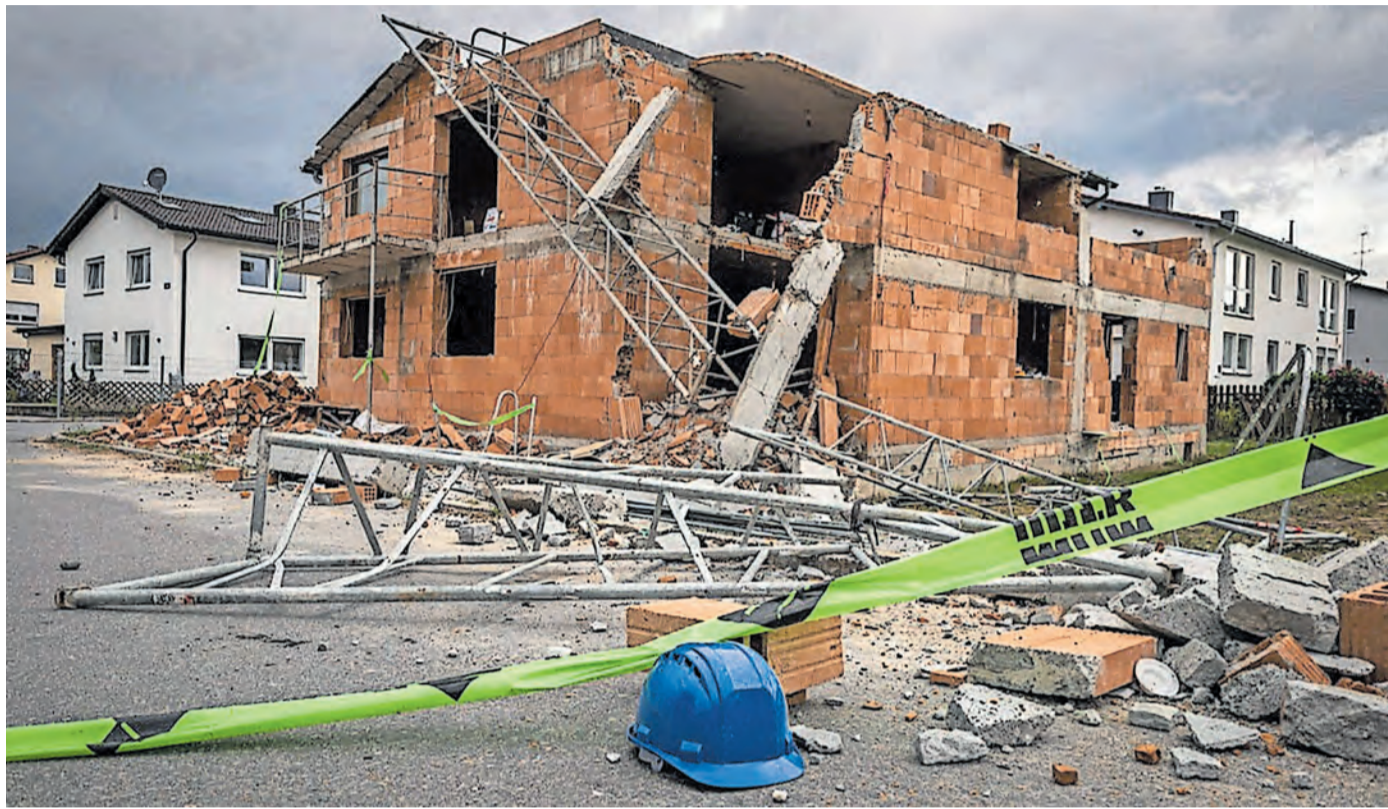
EINE UNZUREICHEND GESCHÜTZTE BAUSTELLE KANN BEI UNWETTER ZUM FIASKO WERDEN.
