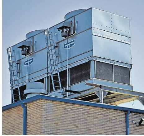
DIE KÜHLUNG IM BÜRO MACHT OFT GROSSE KÜHLSYSTEME AUF DEM DACH NOTWENDIG FOTO: PIXABAY
