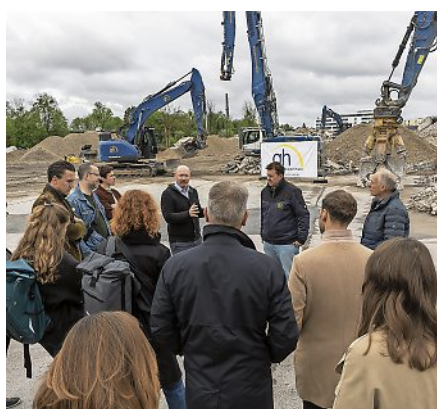
BEIM ABBRUCH WURDE DER SCHUTT PENIBEL GETRENNT UND WIRD DEM RECYCLING ZUGEFÜHRT.
