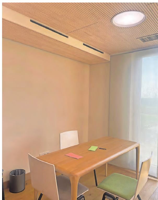
DAS AUTARKE KÜHLBALKENSYSTEM KOMMT IN ALLEN RÄUMEN – WIE AUCH HIER IM TAGUNGSBEREICH – ZUM EINSATZ. FOTO: B. BRUBACHER
